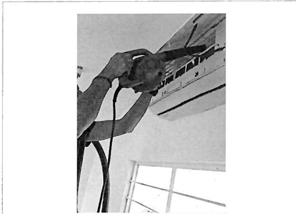
Limpieza de los filtros del sistema de enfriamiento de la caseta (Clima)
