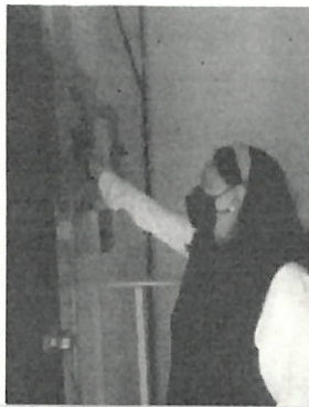
Revisión de sistema eléctrico
