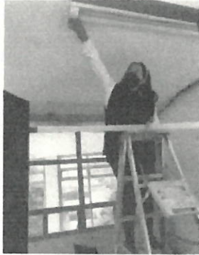
Revisión y limpieza de lámparas
