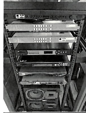
Se realiza limpieza y ajuste de equipos periféricos en cuarto de transmisión.
