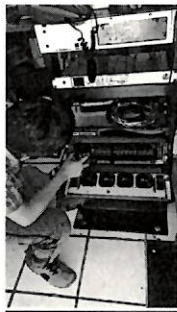
Limpieza con aire comprimido de los ventiladores.
