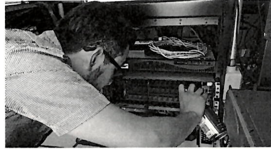
Limpieza con aire comprimido a la electrónica del trasmisor.
