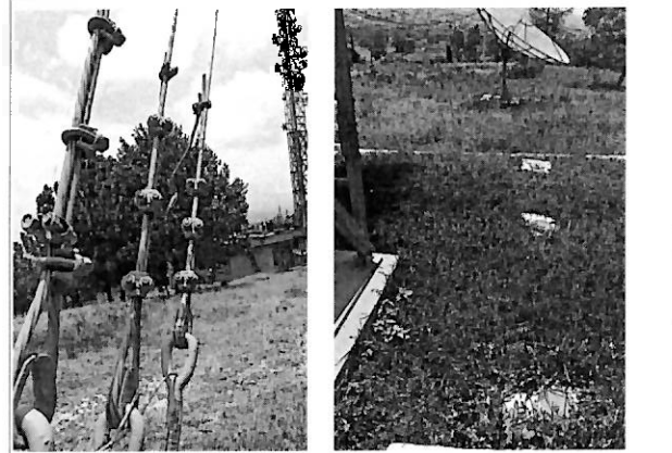
Revisión de retenidas de la torre de transmisión, electrodos y tierras físicas.
