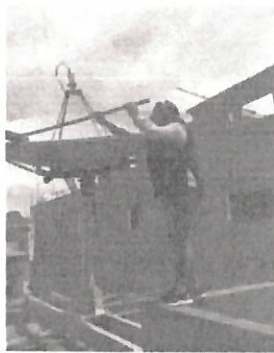
Limpieza de antenas de recepción satelital
